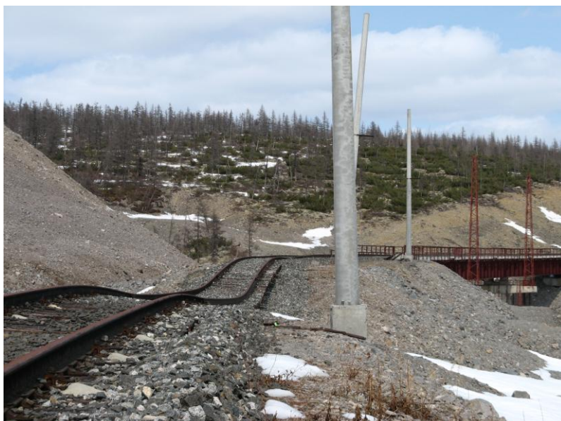
Рис. 56. Деформации земляного полотна на железнодорожном пути Чара-Чина (2010 г.)
